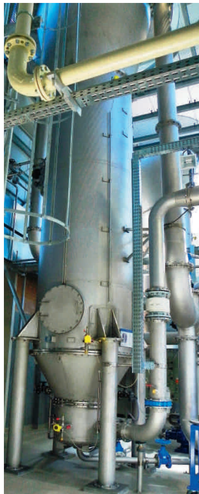
Die neu gebaute Trinkwasserenthärtungsanlage im Wasserwerk «Ottersdorf» in Rastatt.
