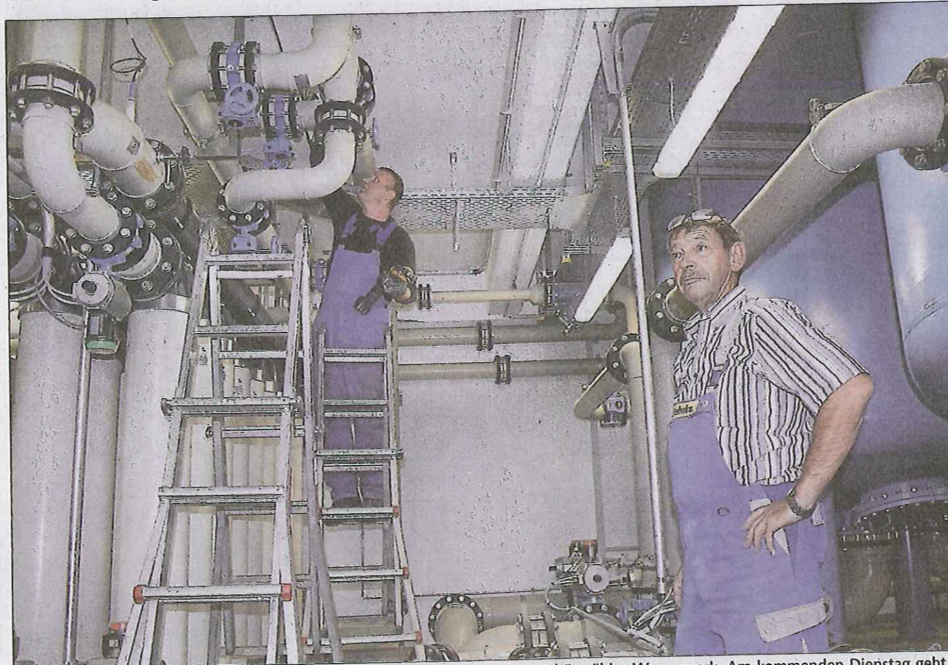
Den letzten Schliff geben derzeit Handwerker und Techniker dem neuen Schönwälder Wasserwerk. Am kommenden Dienstag geht es in Betrieb. Für den Übergangstag ruft die Gemeinde zum sparsamen Umgang mit dem Wasser auf. Foto: Liebau
