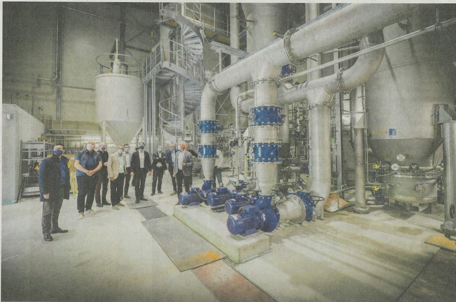
Reine Männerrunde: Vertreter des Zweckverbands Wasserversorgung Ulmer Alb, der Mitgliedskommunen, der Landeswasserversorgung, und der beteiligten Ingenieurbüros betrachten die neue Enthärtungsanlage im Wasserwerk Ehrenstein.
